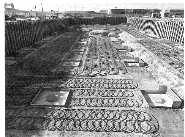
写真-5 温泉棟地下に敷設された「スリンキー式コイル」
