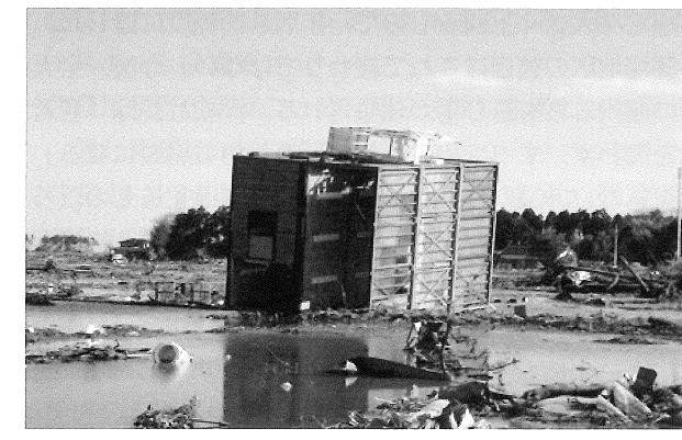
写真-2 倒壊した現場事務所
