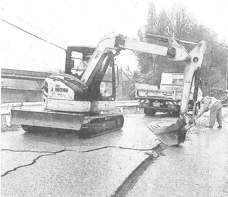
能登半島地震で亀裂が入った道路を補修する深松組＝1月21日、石川県能登町
