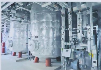
地中熱+下水熱+排ガス熱+排熱湯気を回収、さらに昇温・蓄熱し施設に供給
