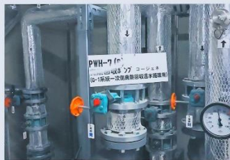
廃熱回収ポンプ
