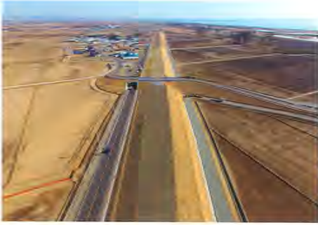
塩釜巨理線道路改築工事藤塚工区（仙台市東部復興道路）
